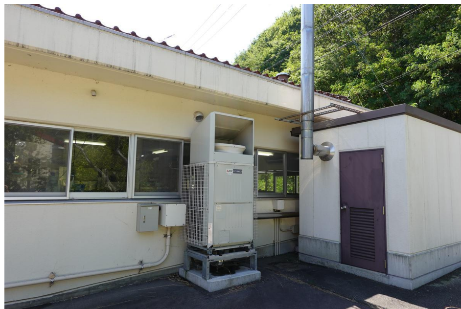
校舎外周・設備機器
