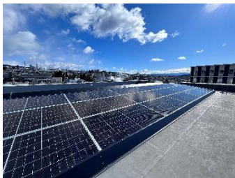
市庁舎、交流センター屋上に設置した太陽光で発電
