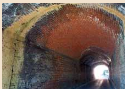
⑤赤坂トンネル (赤坂区)
