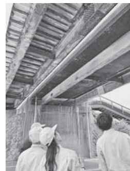
腐食が進む橋りょうを見学（国道18号線加増）
