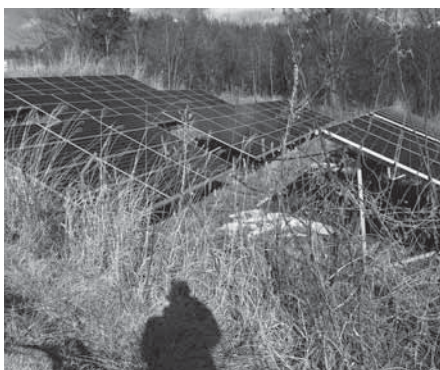
違反の安全柵のない繁茂した放置現場
