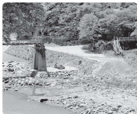
ふるさと遺産第1号の決壊した小諸大杭橋
