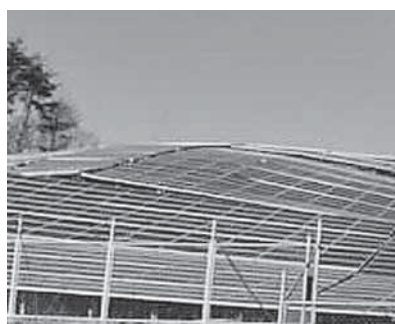
太陽光パネル
