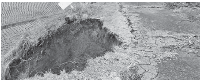
土砂崩落のあった農道
