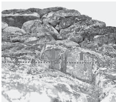
小諸城 天守台 石垣のはらみ (浮き出した目立つ石)
