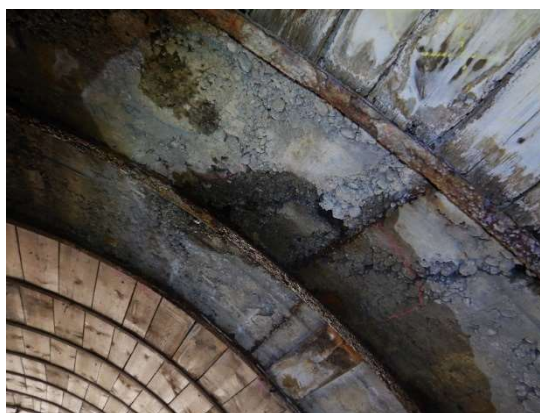
アーチ部からの漏水
