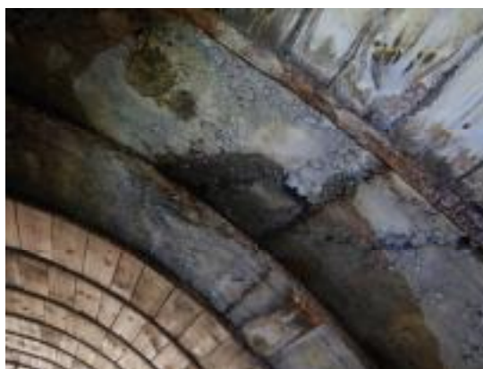
アーチ部からの漏水
