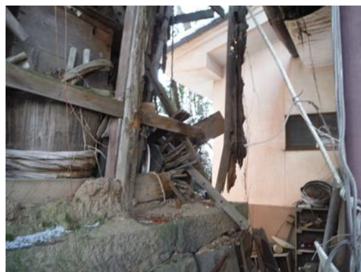
【柱「著しく破損している」の例】
