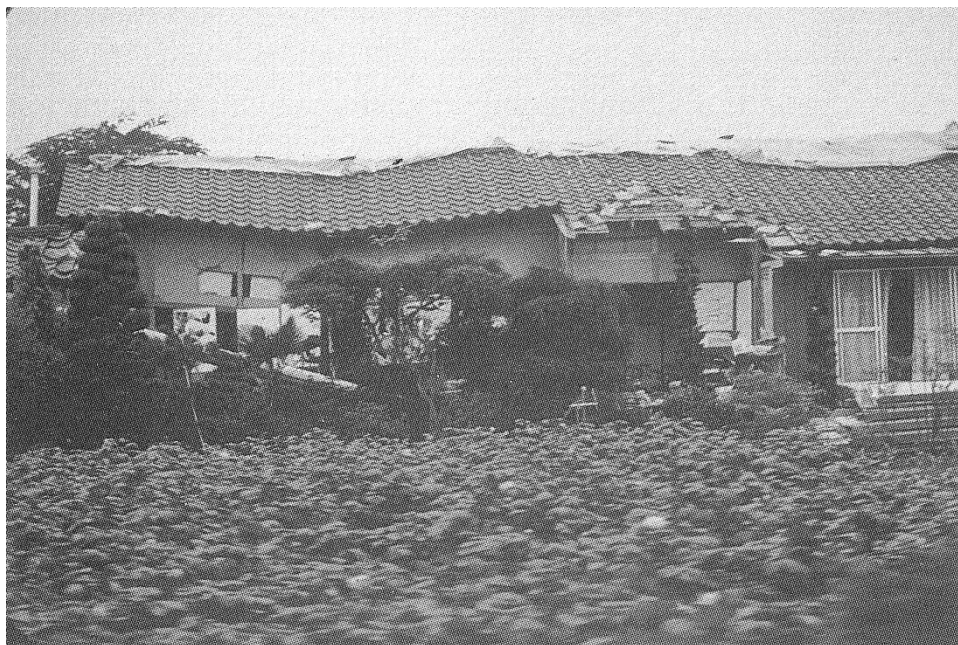
【建築物の不同沈下】
