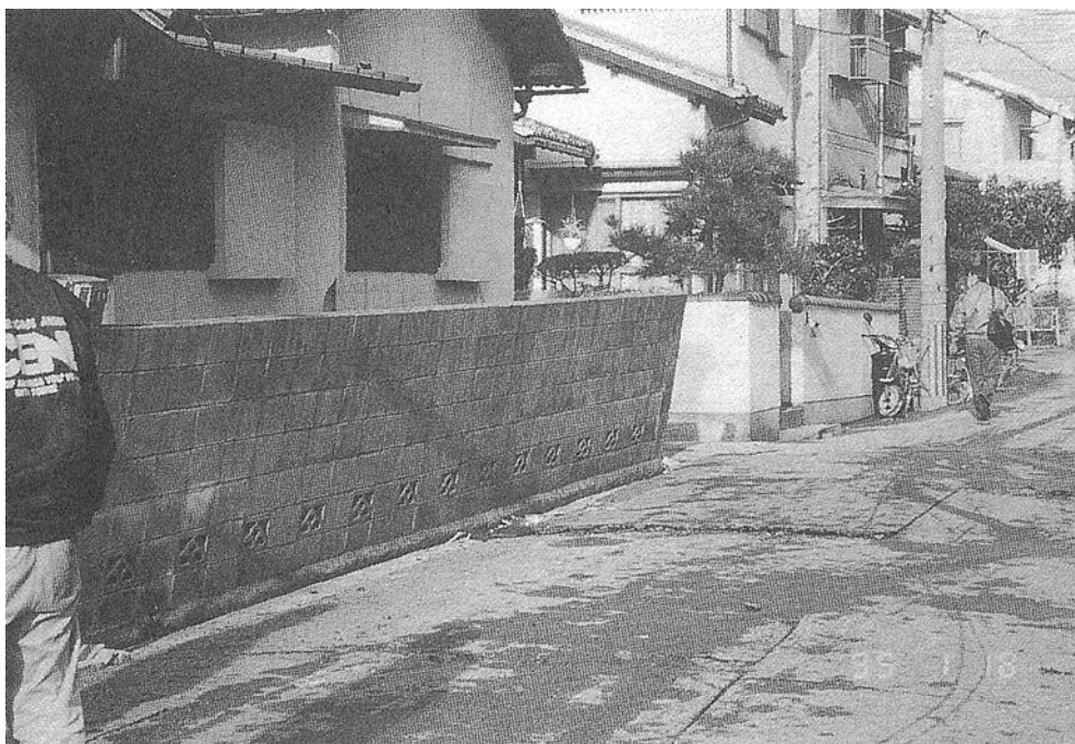
【転倒危険物（ブロック壁）】
