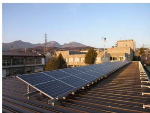
太陽光発電施設（坂の上小学校）
